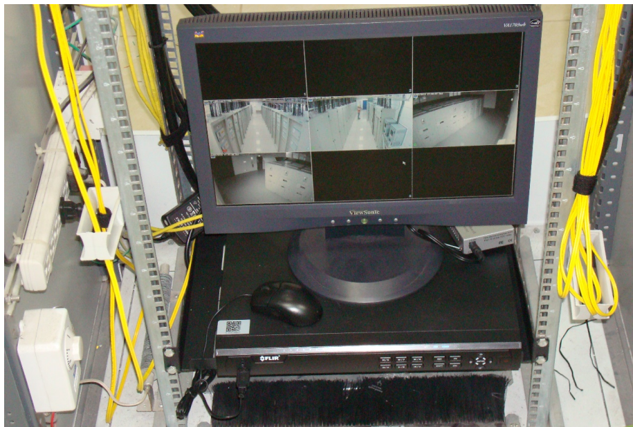
Grabador FLIR NVR con Videowall en Subestación
