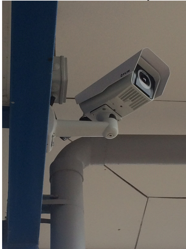
Cámara Térmica FLIR FC en área de subestación.
