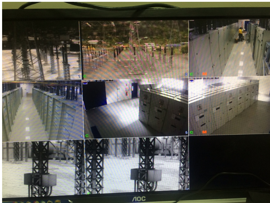
Video Wall mostrando imágenes de todas las cámaras FLIR – visuales y térmicas
