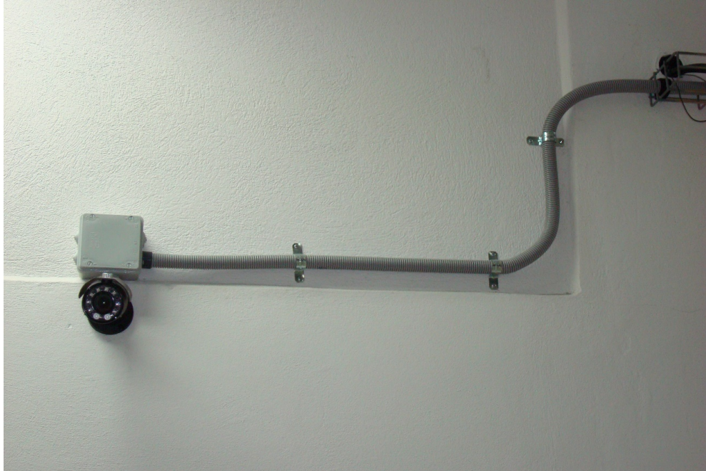
Cámara Visual FLIR en Sala de Control y Sala de Media Tensión
