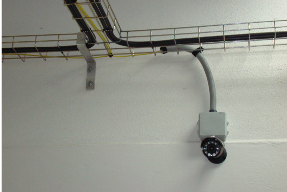
Fotos Cámaras Visuales FLIR en Sala de Control y Sala de Media Tensión
